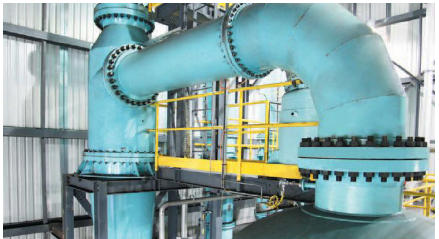
▲ L'équipement de conversion du méthanol produit par Enerkem en éthanol cellulosique à l'usine de Westbury.
